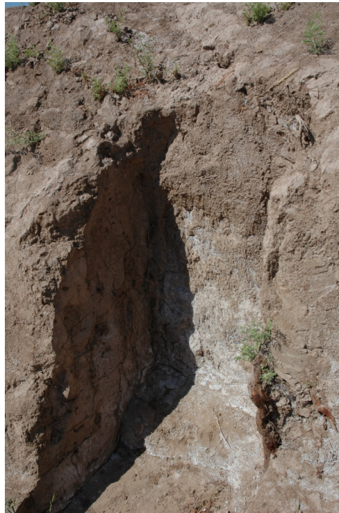
図 3-15 アジナ・テパ遺跡内でみられる塩類析出の例
