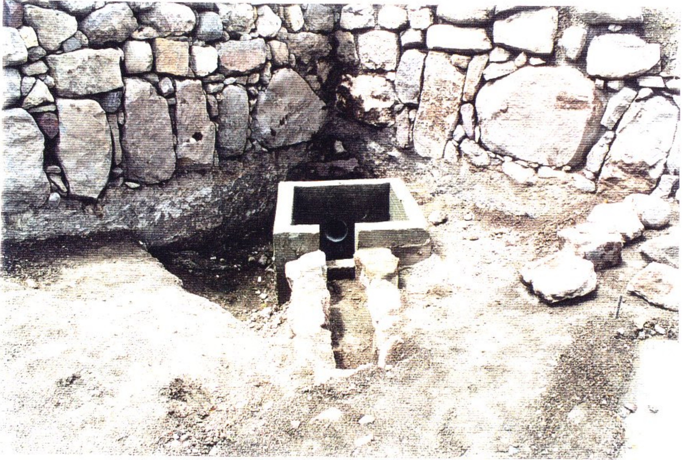
FOTO 19. Canal de drenaje desde la Plaza Central hasta la parte Oeste de la Fachada Frontal (Oct, 2002)
