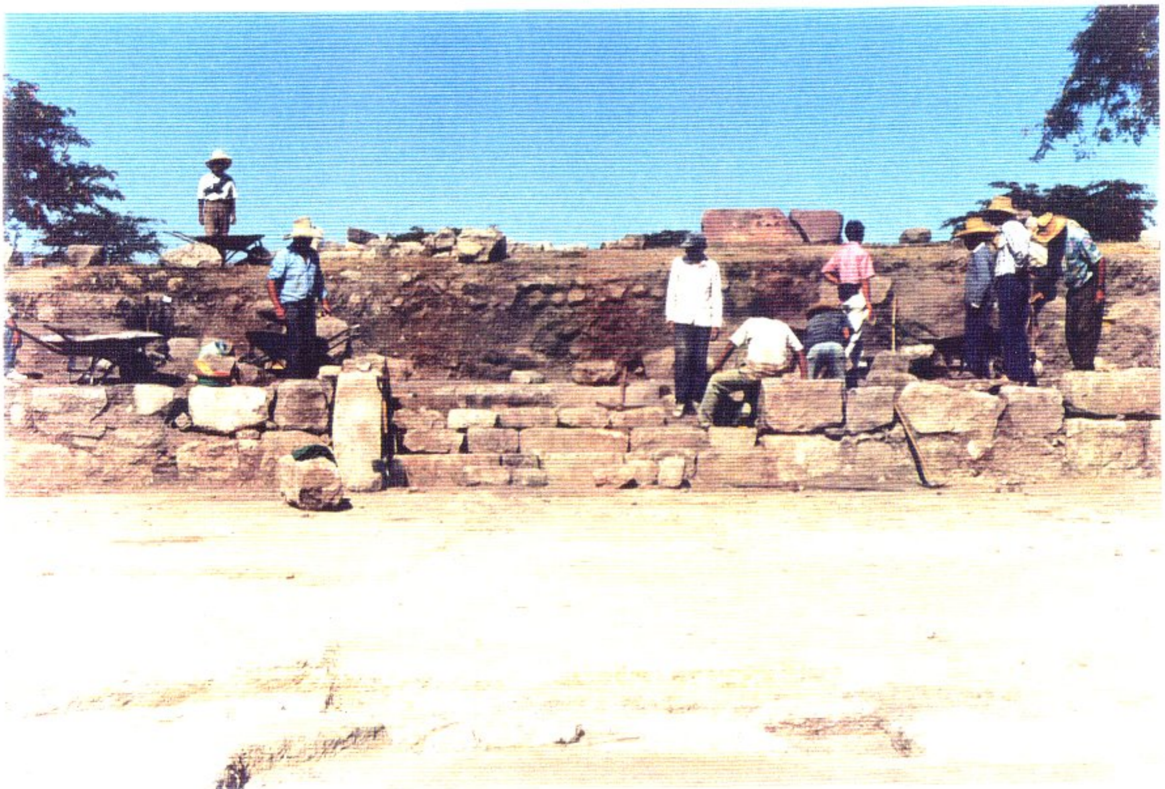
FOTO 16. Restauración del muro de contención y la Escalera Sur en la Plaza Central, durante la ejecución (Ago, 2002)
