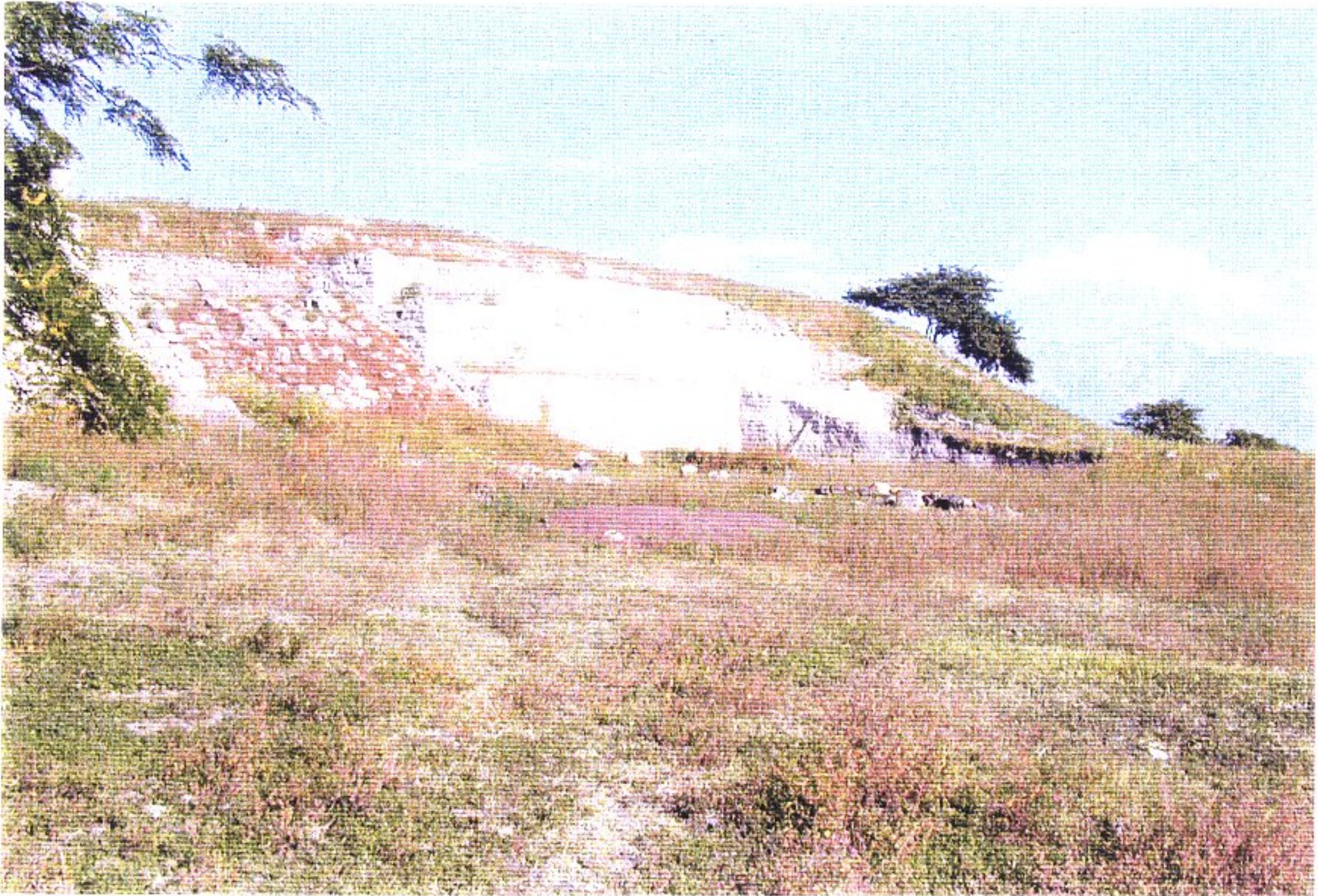
FOTO 1. Antes de la intervención; Sector R, Parte Oeste de la Fachada Frontal (May, 2002)
