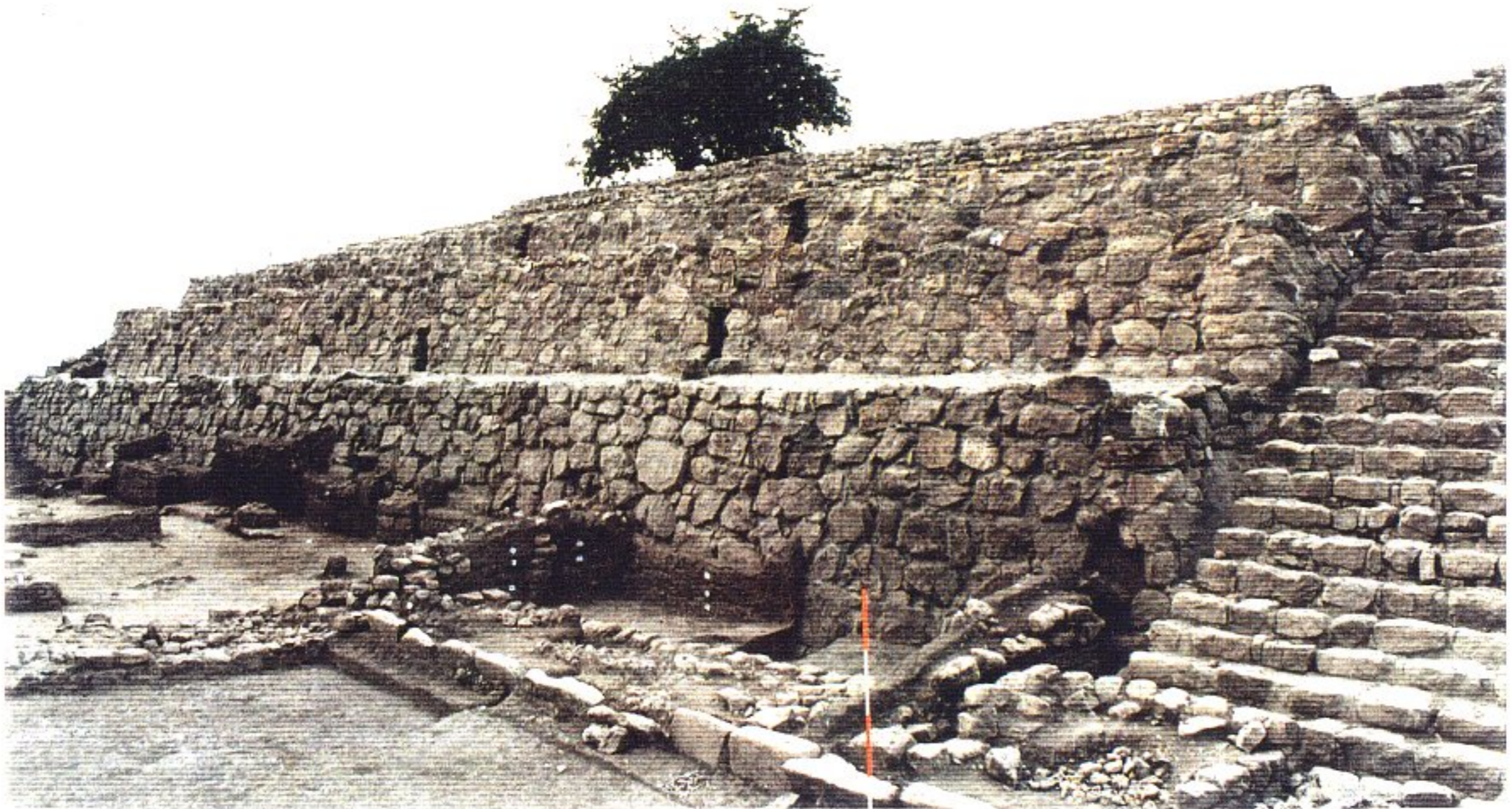
FOTO 7. Durante la intervención; Sector S, Parte Este de la Fachada Frontal (Ago, 2002)
