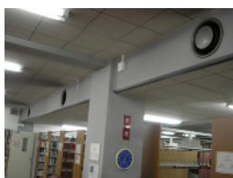
写真2 落下した換気口
