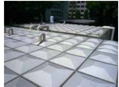
受水槽(手前:市水、向:地下水)
