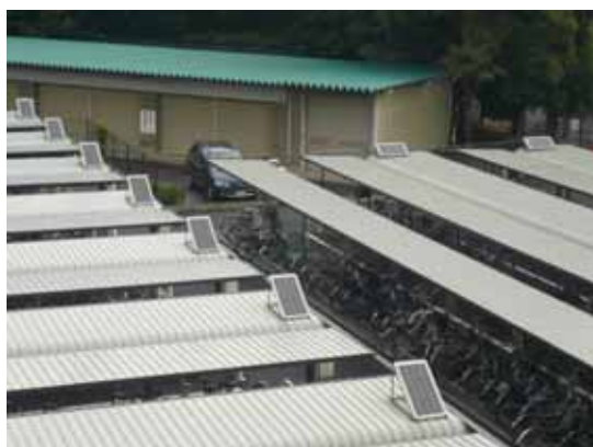
駐輪場屋根のソーラーパネル
