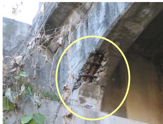
写真-2 主桁の鉄筋露出 (B 橋)
