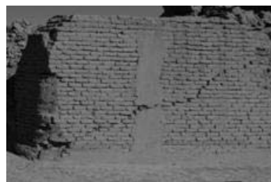
図-1 地震により亀裂が発生した日干し煉瓦壁面（バム遺跡）
