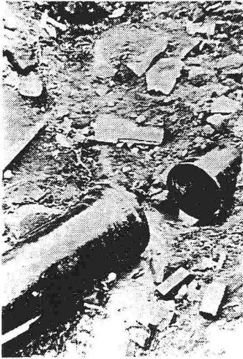
写真1 引張による管の離脱の例 (1923関東地震 Kubo (1) による)
