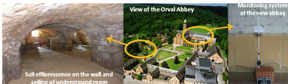
図2 オーバル修道院（中央）の地下室における塩類析出状況（左）とデータロガー設置状況（右）
