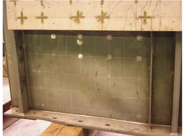
b) ひび割れ発生状況
