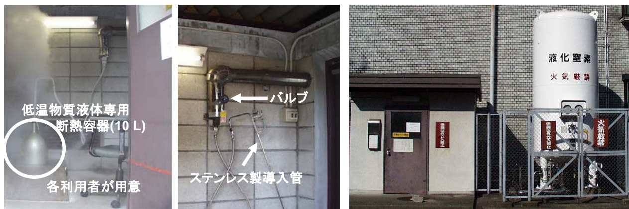
コールドエバポレーター(CE)と液化窒素採取小屋
