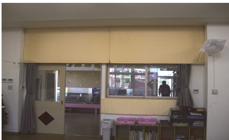
写真1 吸音素材の設置状況 壁面（展開図右手側）の廊下への出入戸上部及び窓下部に仮留めした吸音素材
