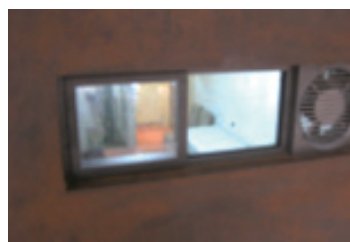
図9-b 側面喚起開口部
