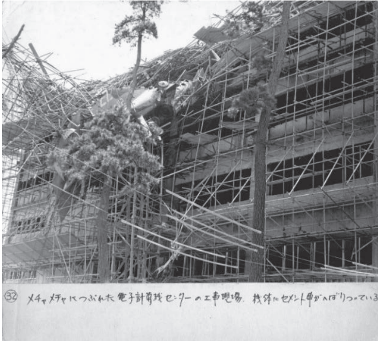
③② 日付なし「メチャメチャにつぶれた電子計算機センターの工場現場 機体にセメント車がへばりついている」
