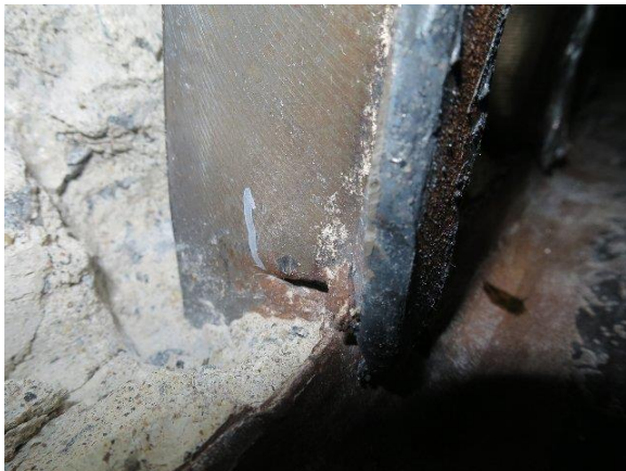
写真 4-9-3 Model-1 供試体 縦リブき裂状況
