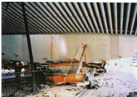
写真 1-2-1 3号神戸線の倒壊した鋼製橋脚
