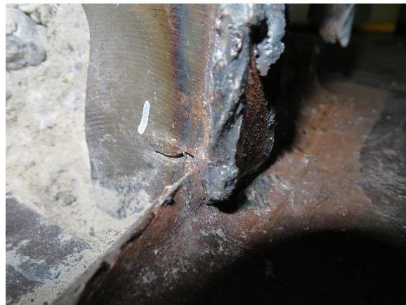
写真 4-9-21 Model-6 供試体 縦リブき裂状況
