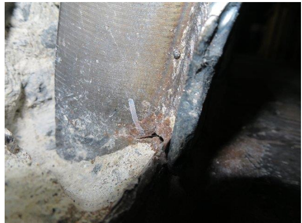
写真 4-9-4 Model-1 供試体 縦リブき裂状況
