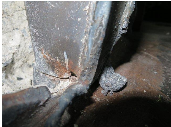
写真 4-9-10 Model-3 供試体 縦リブき裂状況
